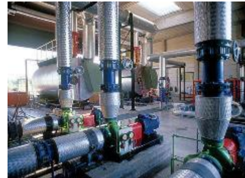
Centrale de Saint Ghislain, 73°C
