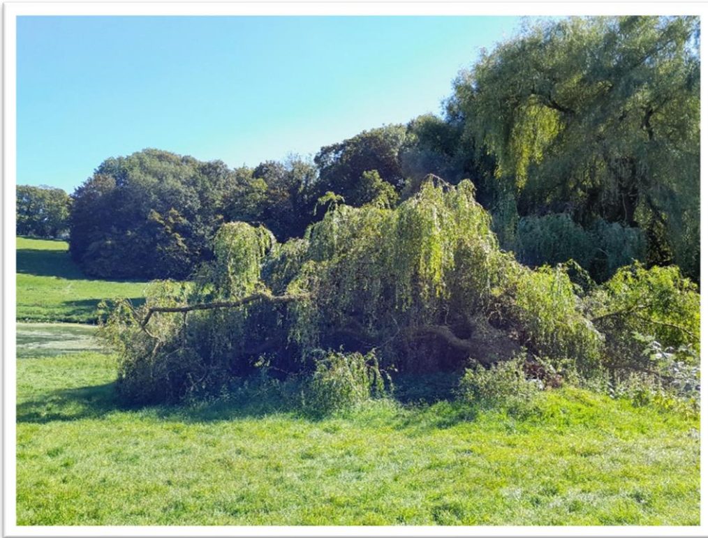
Photo 8 –Saule pleureur n°13244 effondré à remplacer
