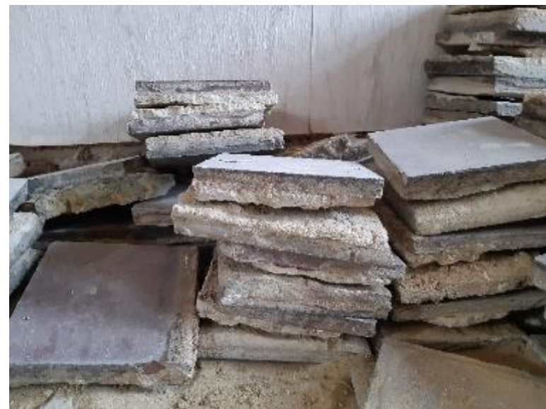
Carreaux de ciment cimentés à nettoyer
