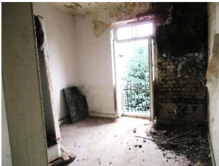
Insalubrité du chantier
