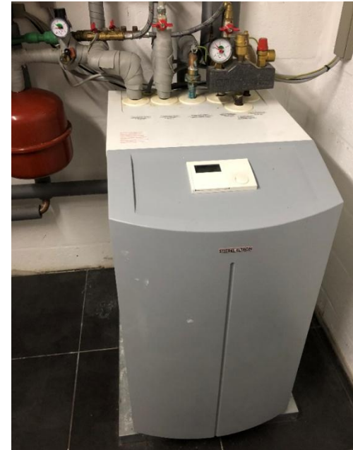
Pompe à chaleur mixte
