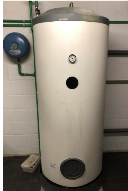
Ballon ECS séparé
