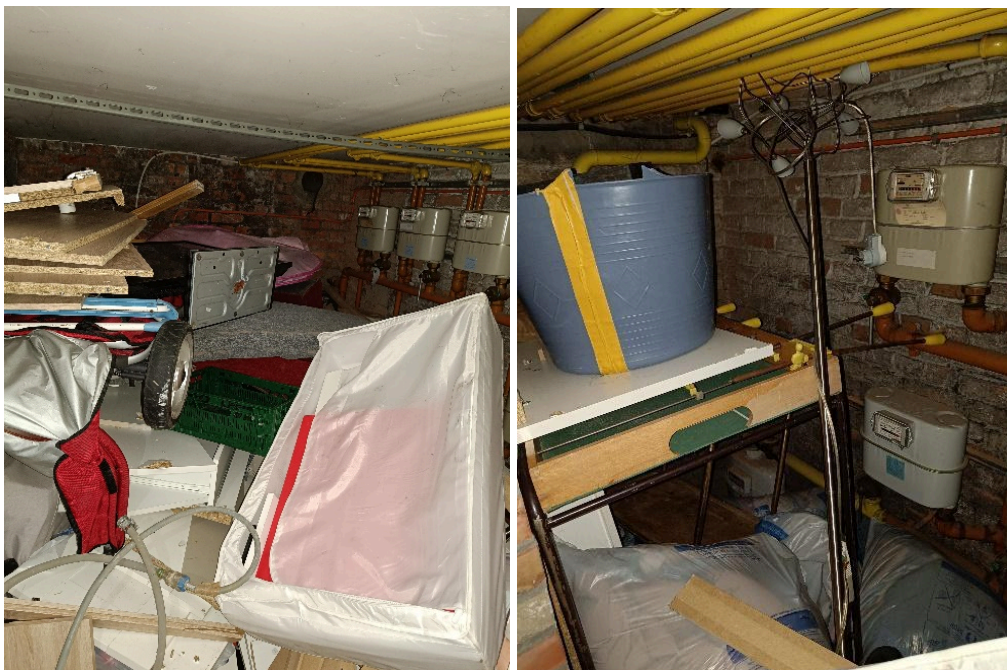
Illustration 11 : Présence d'encombrants dans le locaux techniques (compteurs gaz/électricité)
