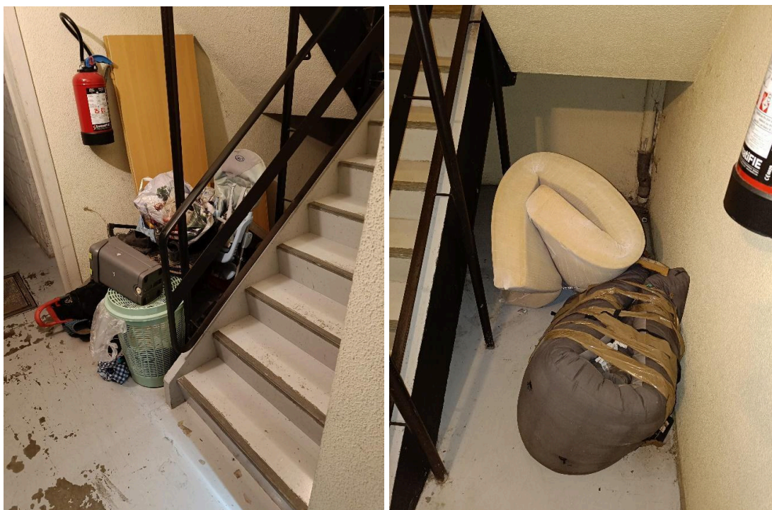
Illustration 13 : Présence d'encombrants dans/sous les cages d'escaliers
