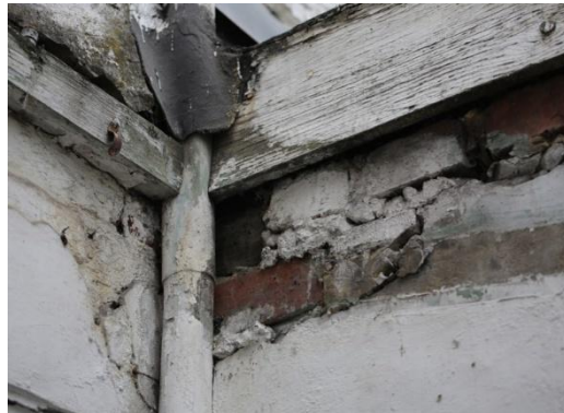
Potentielles sources d'infiltration
