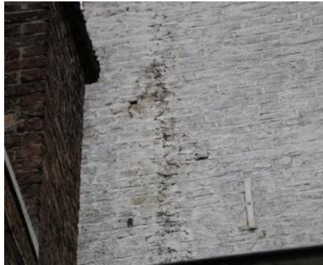
Fissure sur la façade
