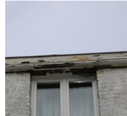
Dégradation de la corniche
