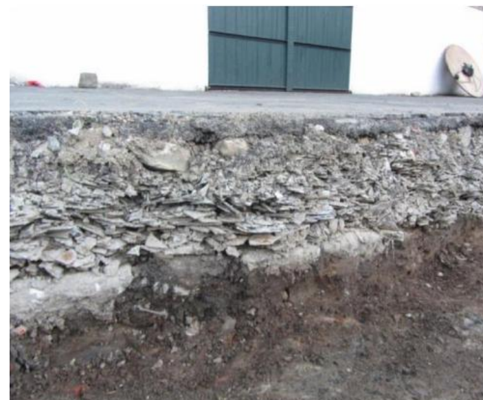
Pièces d'amiante dans couche de remblais
