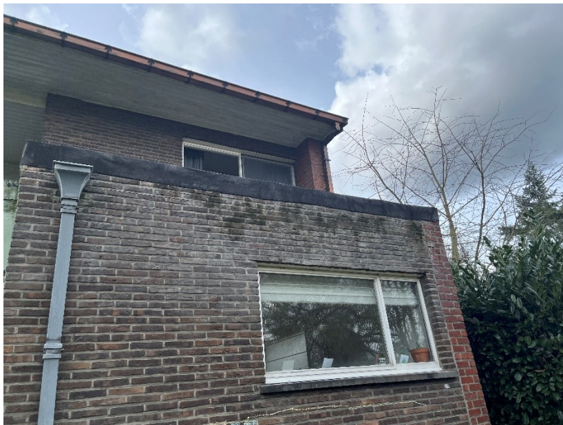
Mauvais débord de toit
