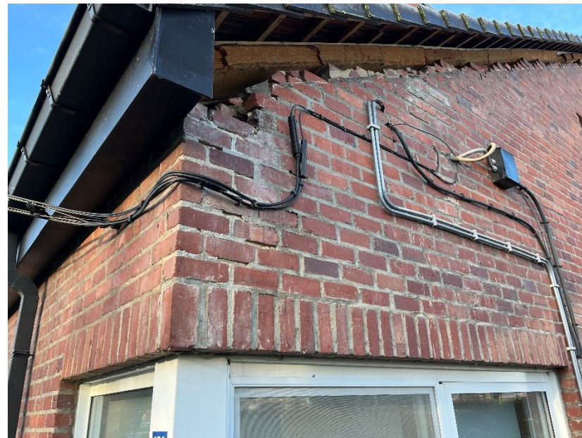
Dégâts causés par le gel et creux ouvert à la jonction avec le toit
