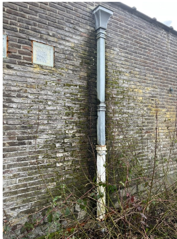
Fuites dans l'évacuation des eaux de pluie
