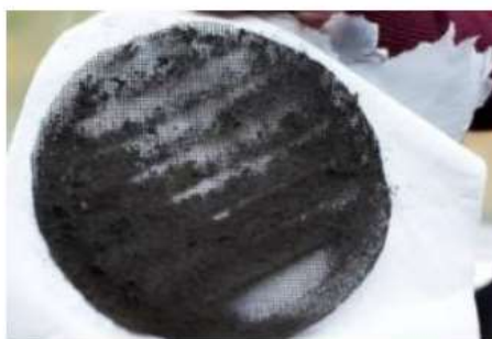
Prise d'air extérieure
