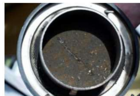
Rejet d'air extérieur
