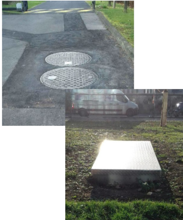
Puits de production / Tampon carrossable ou surélevé
