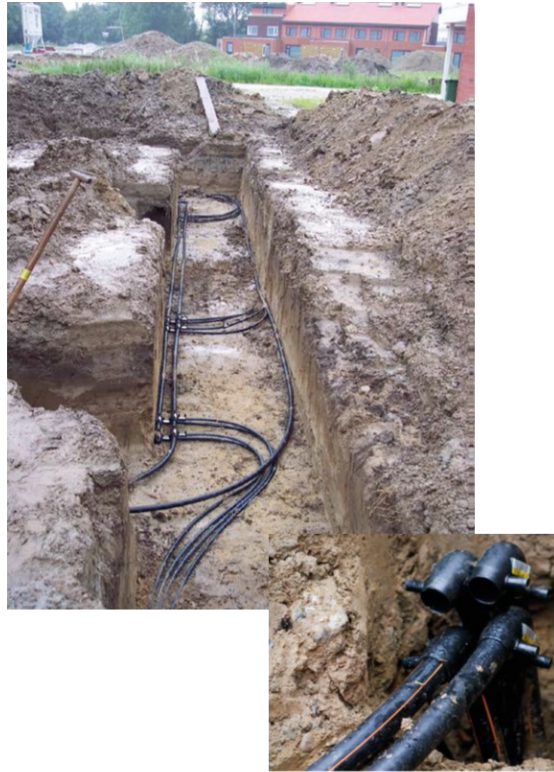
Réseau hydraulique horizontal
