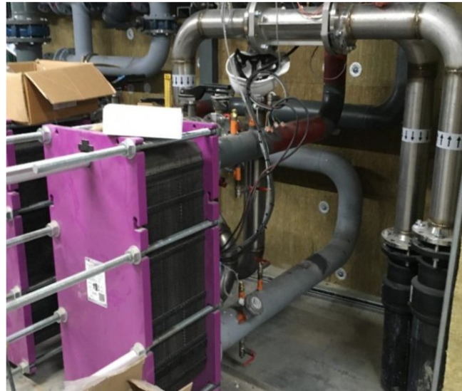
Echangeur à plaques géothermique
