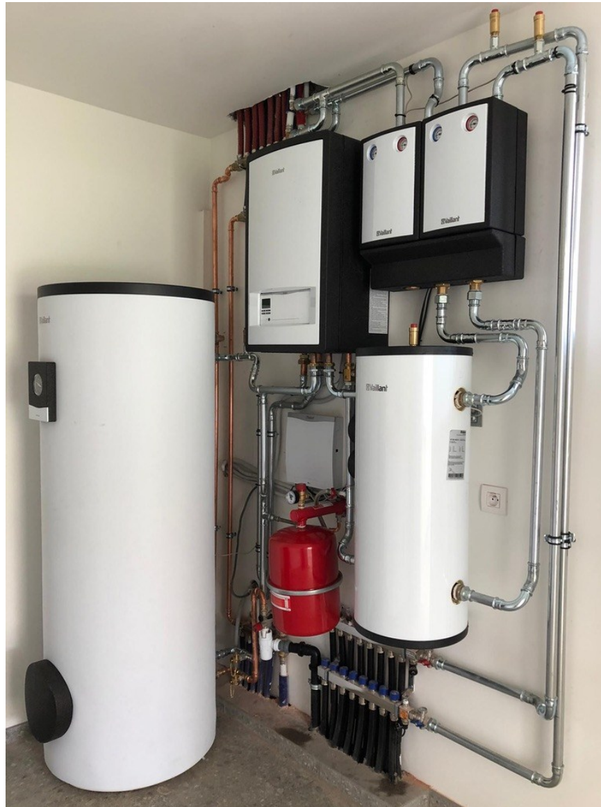
Photo de l'installation
