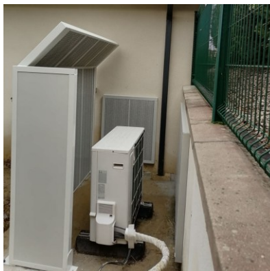
Source image : Energie et Environnement S.A.
