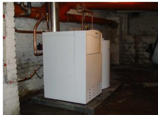
Figure 1.3: exemple de nouvelle installation
