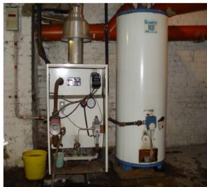
Figure 1.2: exemple de vieille installation
