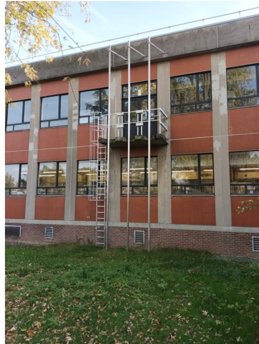
Sorties de secours obsolètes
