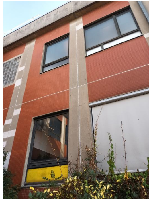
Désordres des façades
