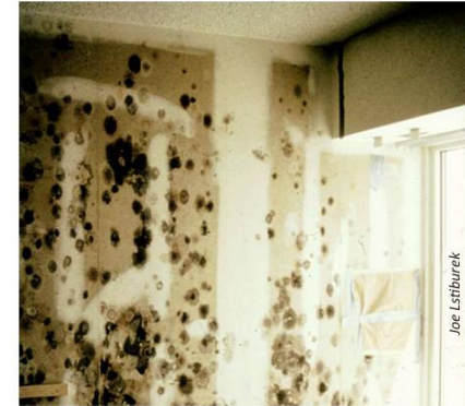
Exemple de moisissures dues à la condensation.
