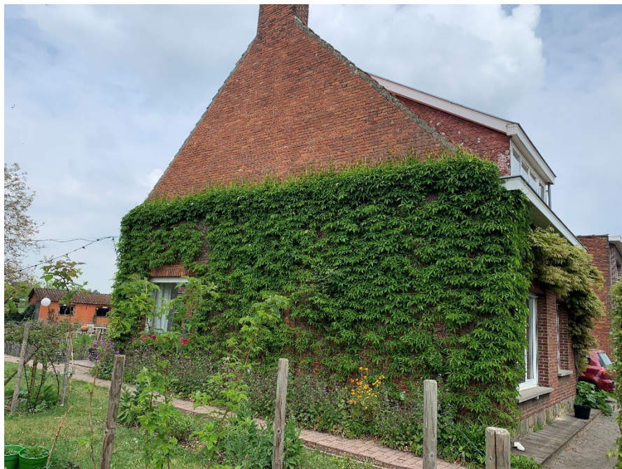
Végétation, dégâts causés par le gel, joint sur sablon ou sable fin
