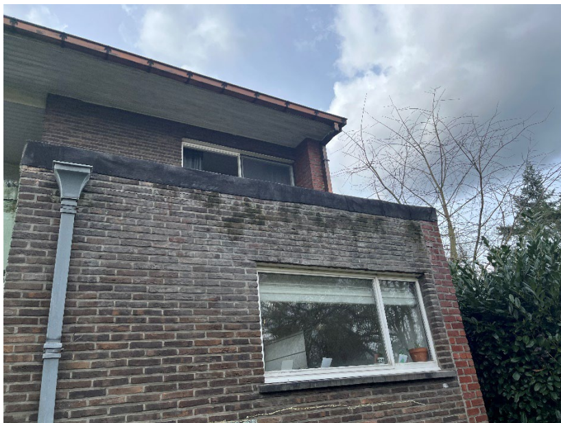
Mauvais débord de toit
