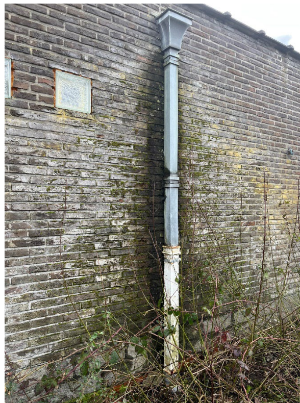
Fuites dans l'évacuation des eaux de pluie
