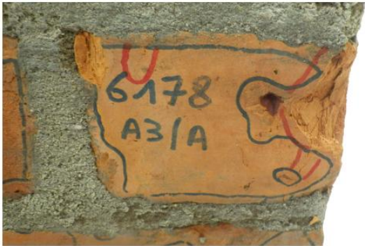
Effritement latéral (local)
