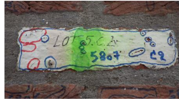
Détachement de la couche de peinture (local)
