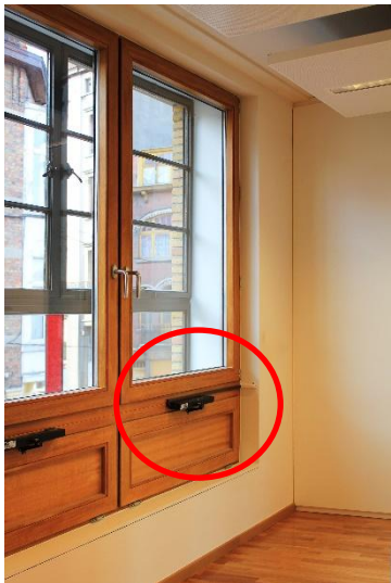
Motorisation des fenêtres
