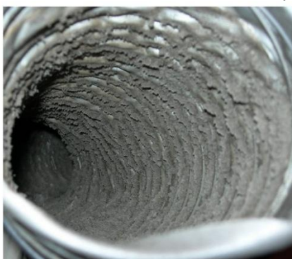
Figure 3.2 : conduit de ventilation encrassé
