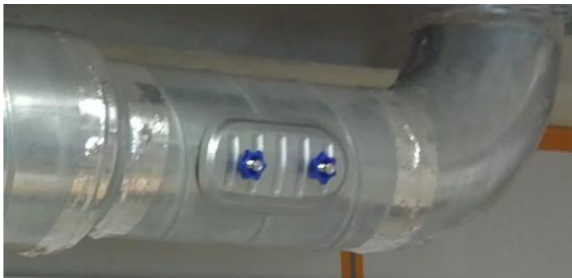
Figure 3.1 : conduit de ventilation muni d'un trapillon de visite
