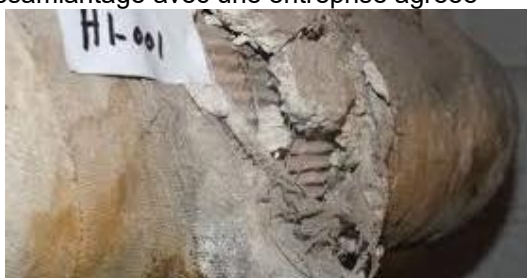
Figure 8.6 – Calorifuge amianté abîmé
