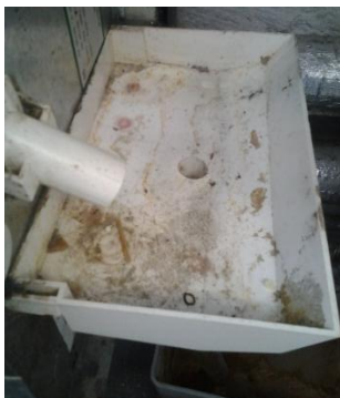
Figure 5.3 évacuation des condensats d'un ventilo-convecteur avant nettoyage
