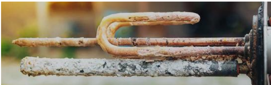
Figure 9.1 : Anode sacrificielle entartrée (en bas)
