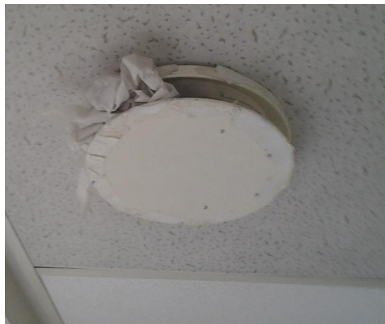
Figure 3.4 : problème de répartition du débit d'air
