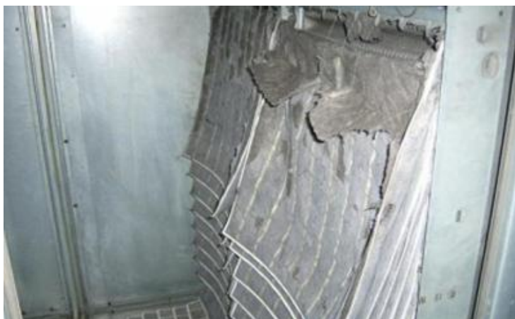
Figure 2.5 filtre à poches déchiré
