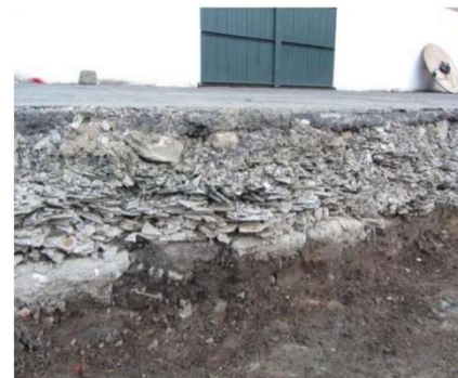
Pièces d'amiante dans couche de remblais
