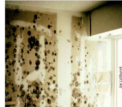
Exemple de moisissures dues à la condensation.
