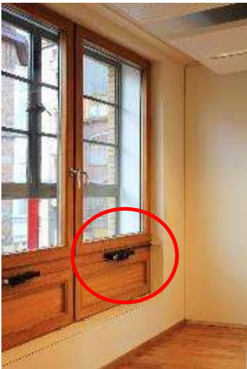
Motorisation des fenêtres
