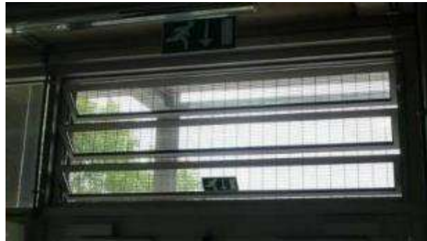
Protection des fenêtres contre l'intrusion
