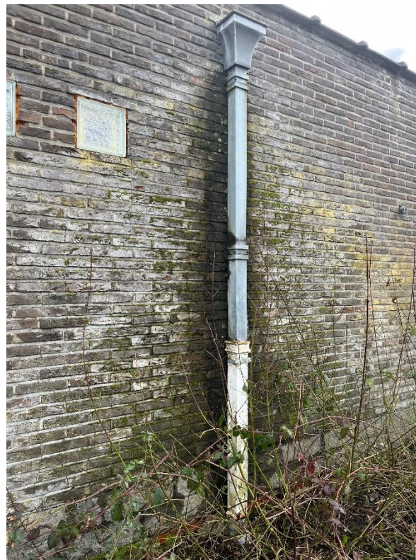
Fuites dans l'évacuation des eaux de pluie
