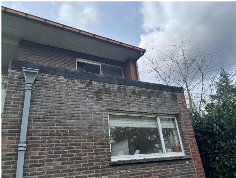
Mauvais débord de toit
