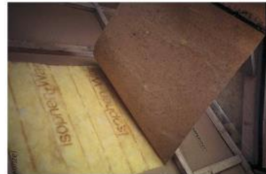
Exemple de moisissures à l'arrière de la membrane pour réguler la vapeur.
