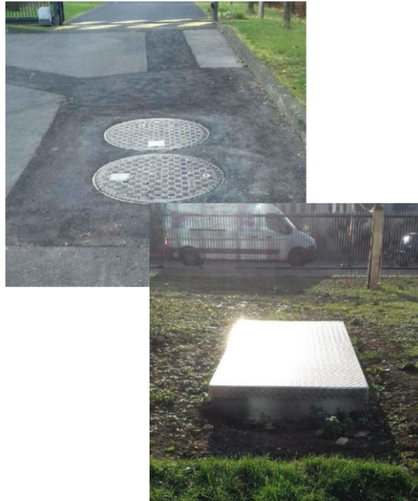
Puits de production / Tampon carrossable ou surélevé
