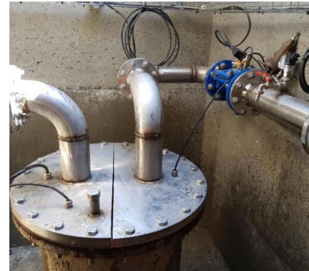
Puits de production / Bride étanche d'une tête de forage
