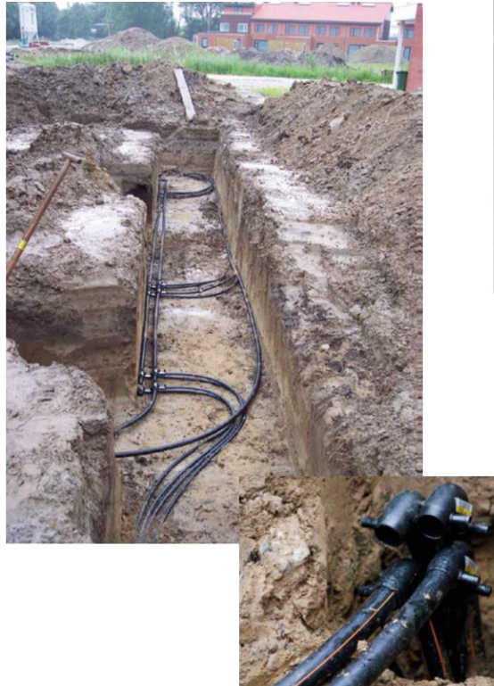
Réseau hydraulique horizontal
