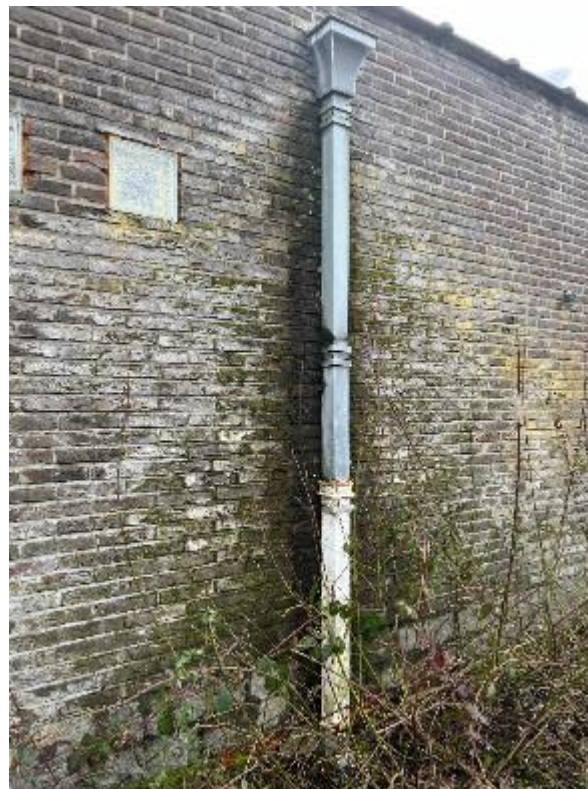
Fuites dans l'évacuation des eaux de pluie
