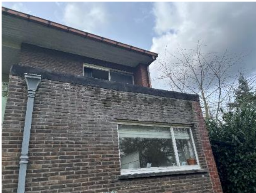
Mauvais débord de toit
