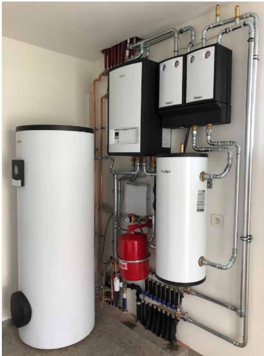
Photo de l'installation
