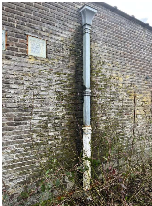
Fuites dans l'évacuation des eaux de pluie
