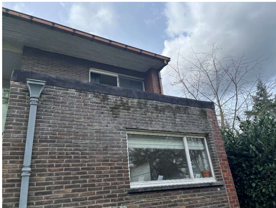
Mauvais débord de toit
