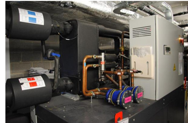
Pompe à chaleur eau/eau de 250 kW
