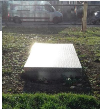
Puits de production / Tampon carrossable ou surélevé
