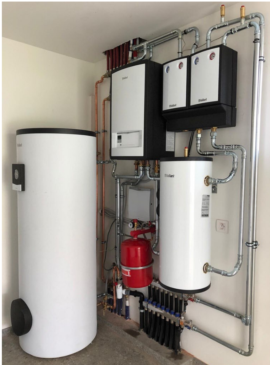
Photo de l'installation
