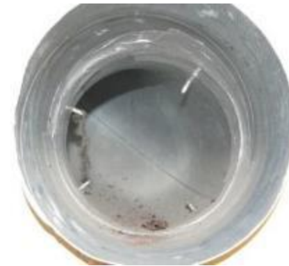
Mauvais filtre → conduits encrassés!
