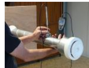
Sonde + conduit au niveau de la bouche
