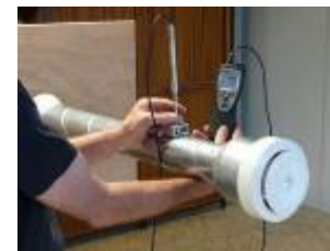
Sonde + conduit au niveau de la bouche
