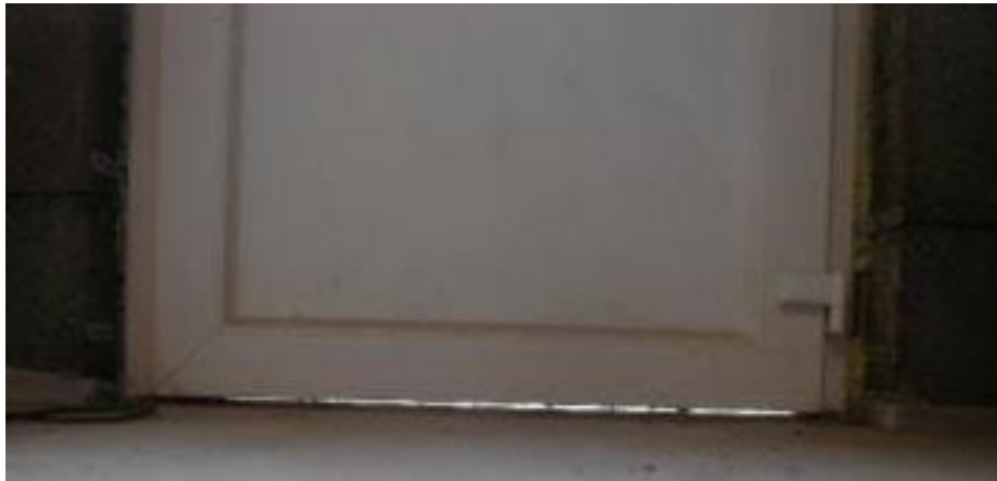
Exemple de fuites d'air au niveau du seuil des portes
